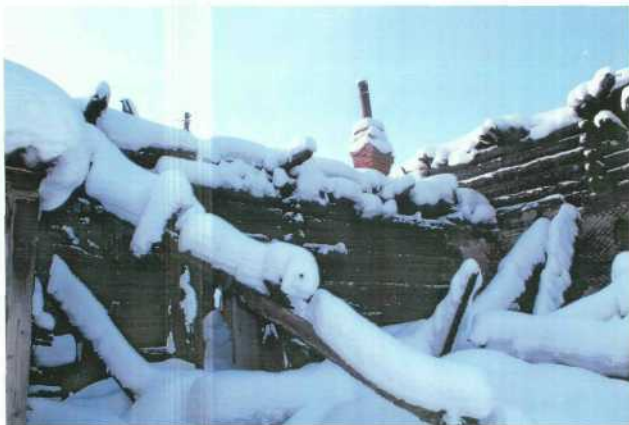
Фото № 11. Общий вид на объект культурного наследия. Северный фасад. Повреждения объекта при пожаре. Фото: Пономарева О.Г. 05.02.2014.
