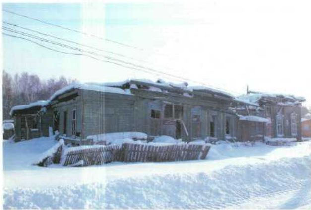
Фото № 1. Общий вид на объект культурного наследия. Южный фасад. Повреждения объекта при пожаре. Фото: Пономарева О.Г. 05.02.2014.
