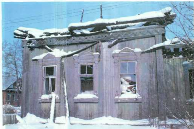
Фото № 4. Общий вид на объект культурного наследия. Восточный фасад. Повреждения объекта при пожаре. Фото: Пономарева О.Г. 05.02.2014.
