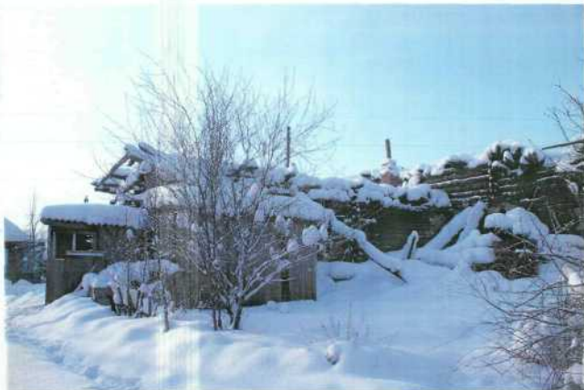
Фото № 6. Общий вид на объект культурного наследия. Северный фасад. Повреждения объекта при пожаре. Фото: Пономарева О.Г. 05.02.2014.
