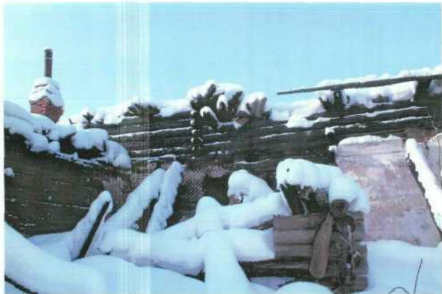
Фото № 10. Общий вид на объект культурного наследия. Северный фасад. Повреждения объекта при пожаре. Фото: Пономарева О.Г. 05.02.2014.
