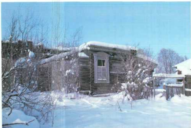
Фото № 8. Общий вид на объект культурного наследия. Северный фасад. Повреждения объекта при пожаре. Фото: Пономарева О.Г. 05.02.2014.
